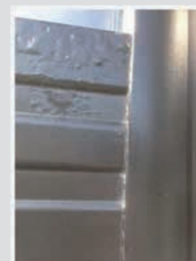
Exemple de corrosion d'un portail laqué aluminium, situé à 8 km de la mer, sans traitement Sea Side Ox
